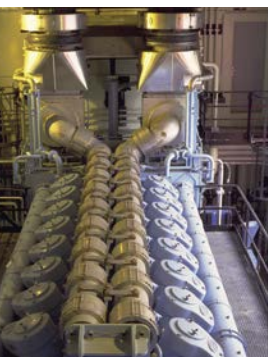
Un des deux groupes électrogènes de secours fonctionnant au fioul.
